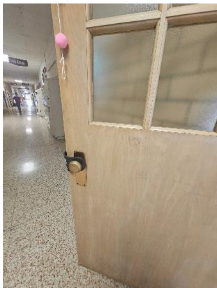
Non-accessible door hardware.
