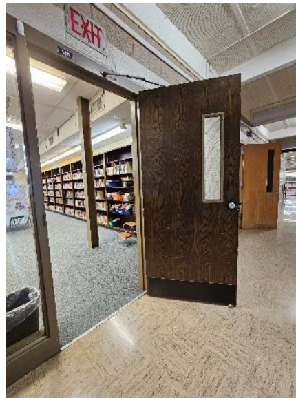
Non-accessible door hardware.
