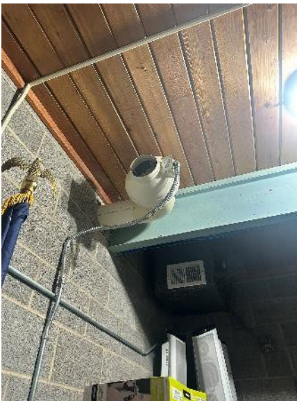
Inline fan to IT room
